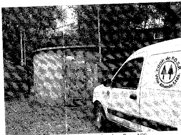
Imagen 3: Sistema de bombeo Pozo N°9
